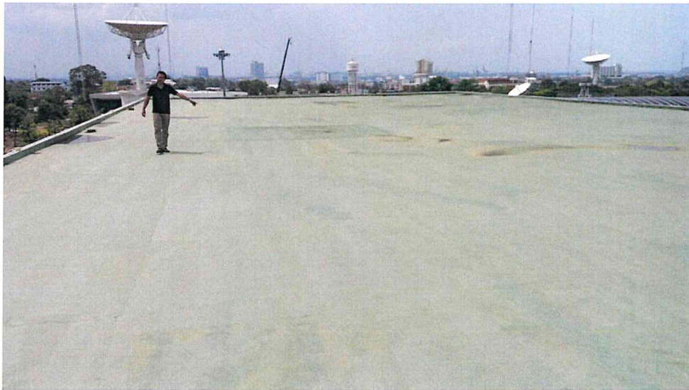
ภาพพื้นดาดฟ้าอาคาร 51 เกิดการเสื่อมสภาพและชำรุด
