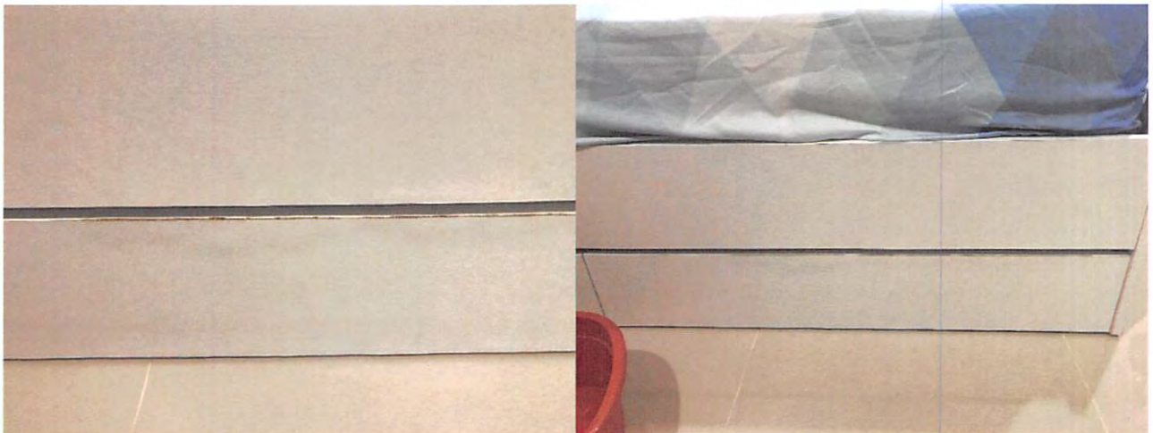
เตียงนอนบวม เนื่องจากน้ำรั่ว
