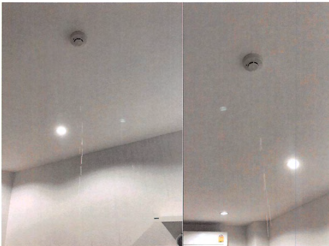
น้ำรั่วมาจากตัวจับควัน ห้อง 401
