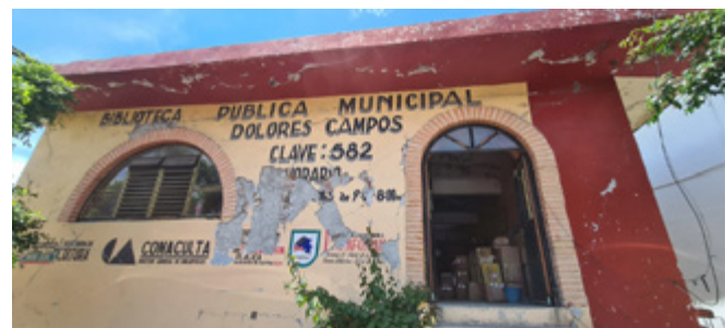
Daños en la biblioteca municipal de Chietla.
