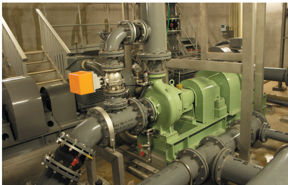
●水道水の送水所内に設置されたマイクロ水力発電設備 (施工:株式会社和田電業社)
