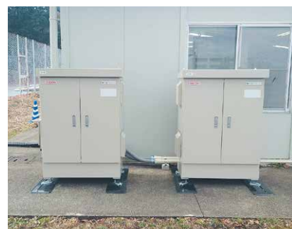
リコー環境事業開発センター（静岡県御殿場市）に設置された双方向マイクログリッドシステムの制御機器
