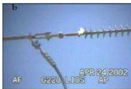
Gambar 68 Insulator yang tidak terpasang korona ring
