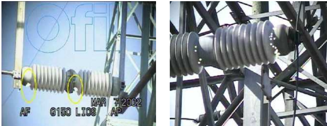
Gambar 72 Gap discharge pada insulator
