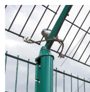
Mise à la terre
