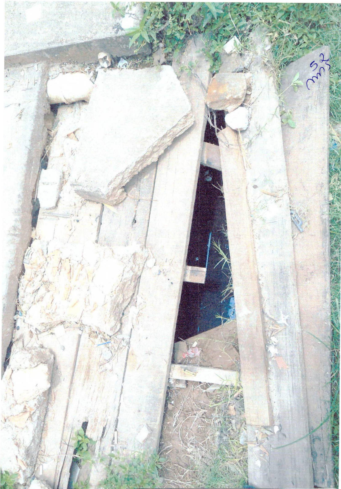
VISÃO APROXIMADA DA CAIXA COM GRELHA E DE SEU CONTEÚDO (AGUAS SERVIDAS).
