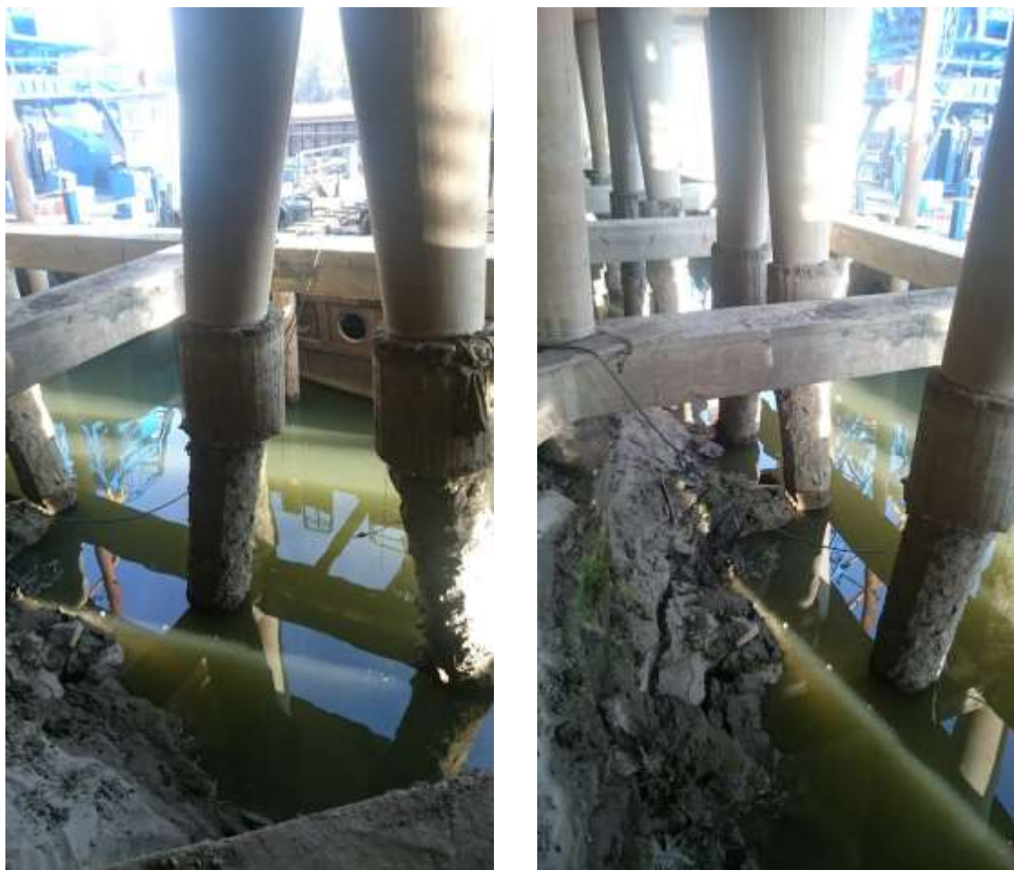
Slika 2.2: Karakterističan izgled oštećenja pilota stupova
