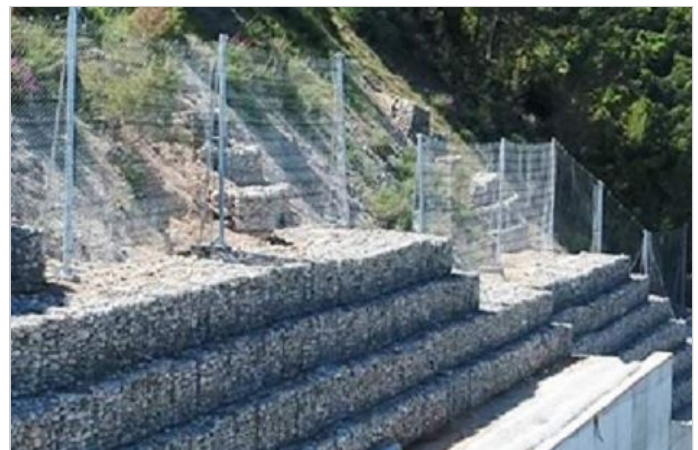
Φράκτης Ανάσχεσης Βραχοπτώσεων RB100UAF σε τοίχιο αντιστήριξης (συρματοκιβώτια)
