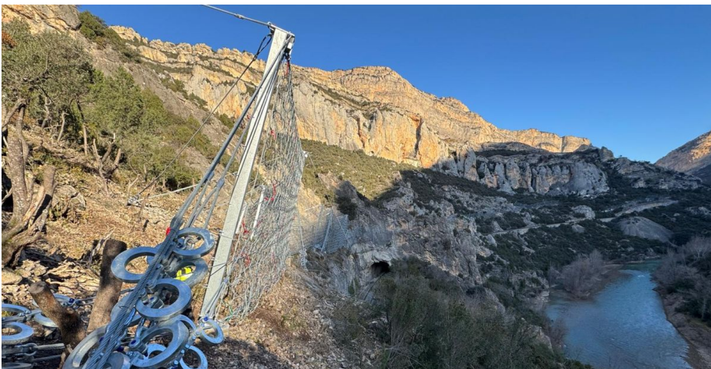
Vista de la barrera RB3000 y la vía
