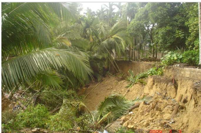
施工前 岸坡坍塌情况
