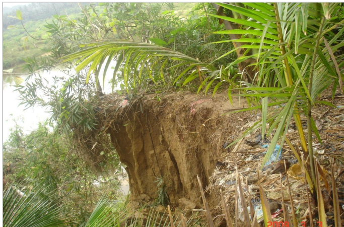
施工前 岸坡坍塌情况
