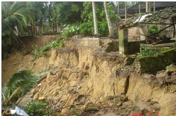
施工前 岸坡坍塌情况
