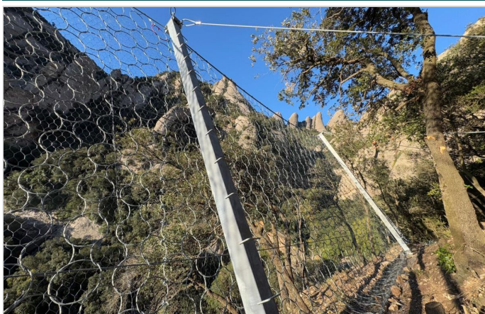
Barrera RB3000 vista desde el lado monte
