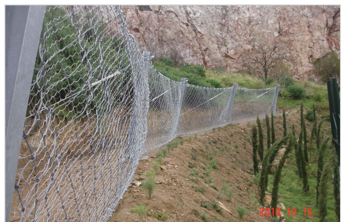
ΚΑΤΑΝΤΙ ΠΛΕΥΡΑ ΦΡΑΚΤΗ RMC 200A
