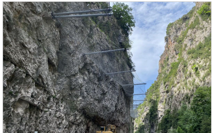
Barreras EPFM 5000 en galería
