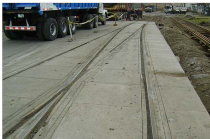
Parte de pavimento vaciado en uso
