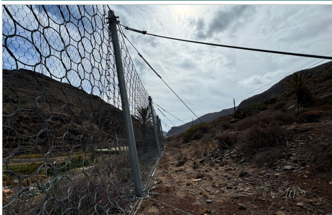
Barrera EPFM 5000 vista desde el talud
