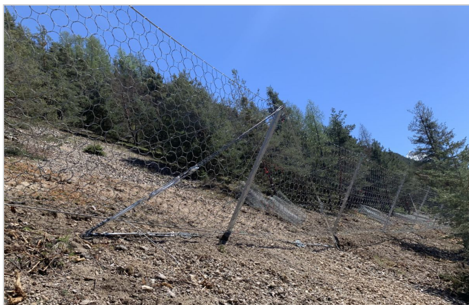
Poteau partagé pour le sectionnement de la ligne
