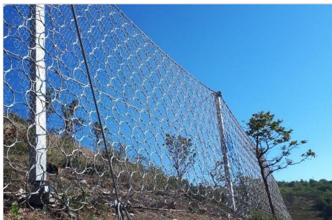
Vista di dettaglio della barriera paramassi RB 2000
