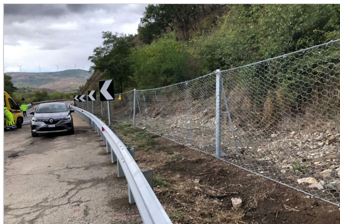
Vista della barriera paramassi RB 100 UAF installata a bordo strada
