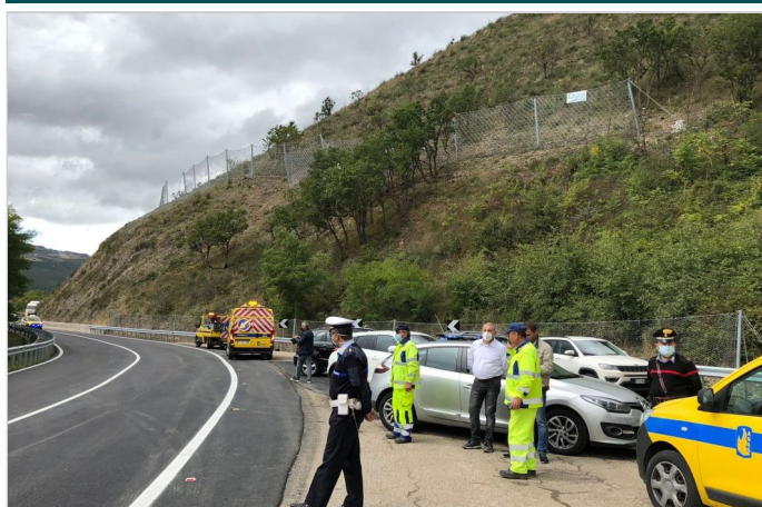
Vista generale delle barriere paramassi RB 2000 installate sul versante
