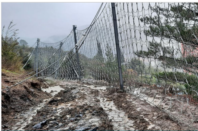
Vista cables de sujeción a monte barrera dinámica RB 1500
