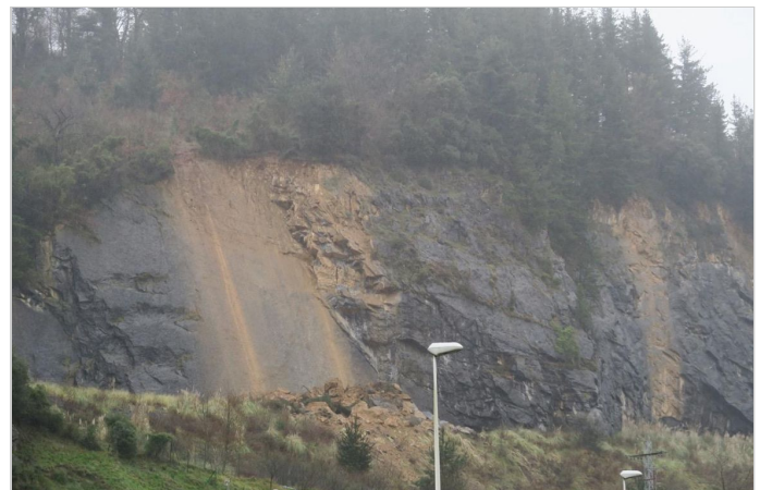
Localización y detalle del desprendimiento de febrero de 2018
