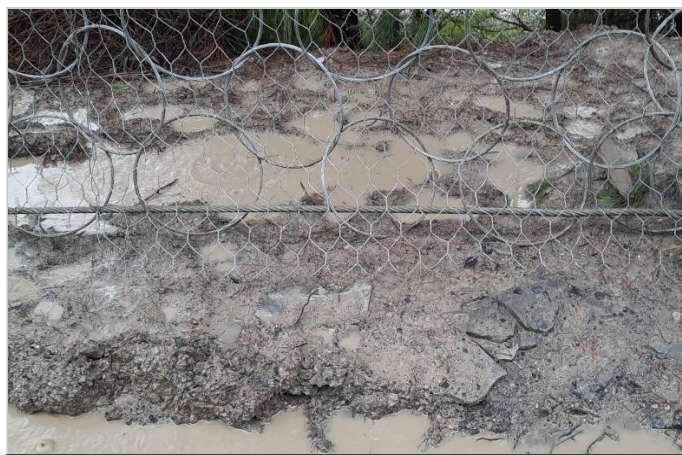
Detalle red de anillos y malla secundaria DT 8x10-16 de la RB 1500
