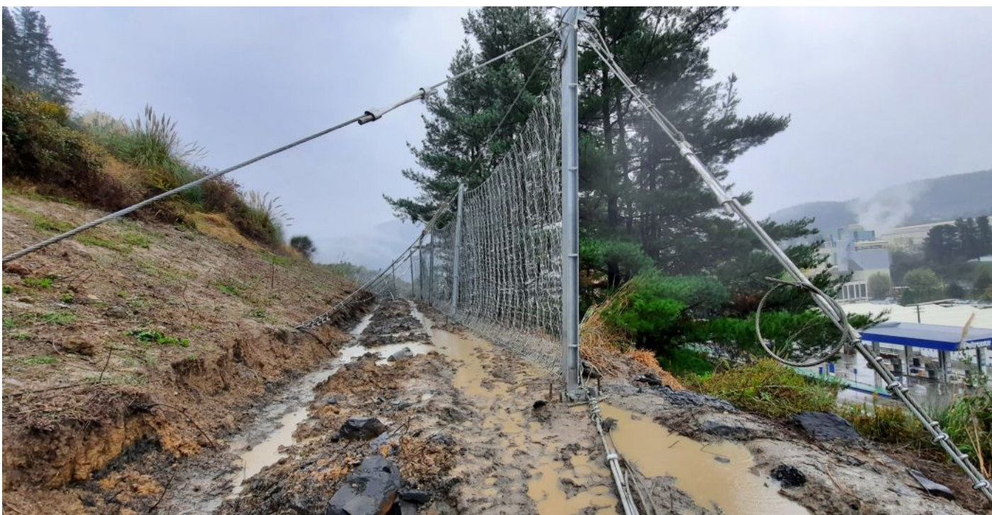
Vista general de la barrera dinámica RB 1500, H=4m, L=60m
