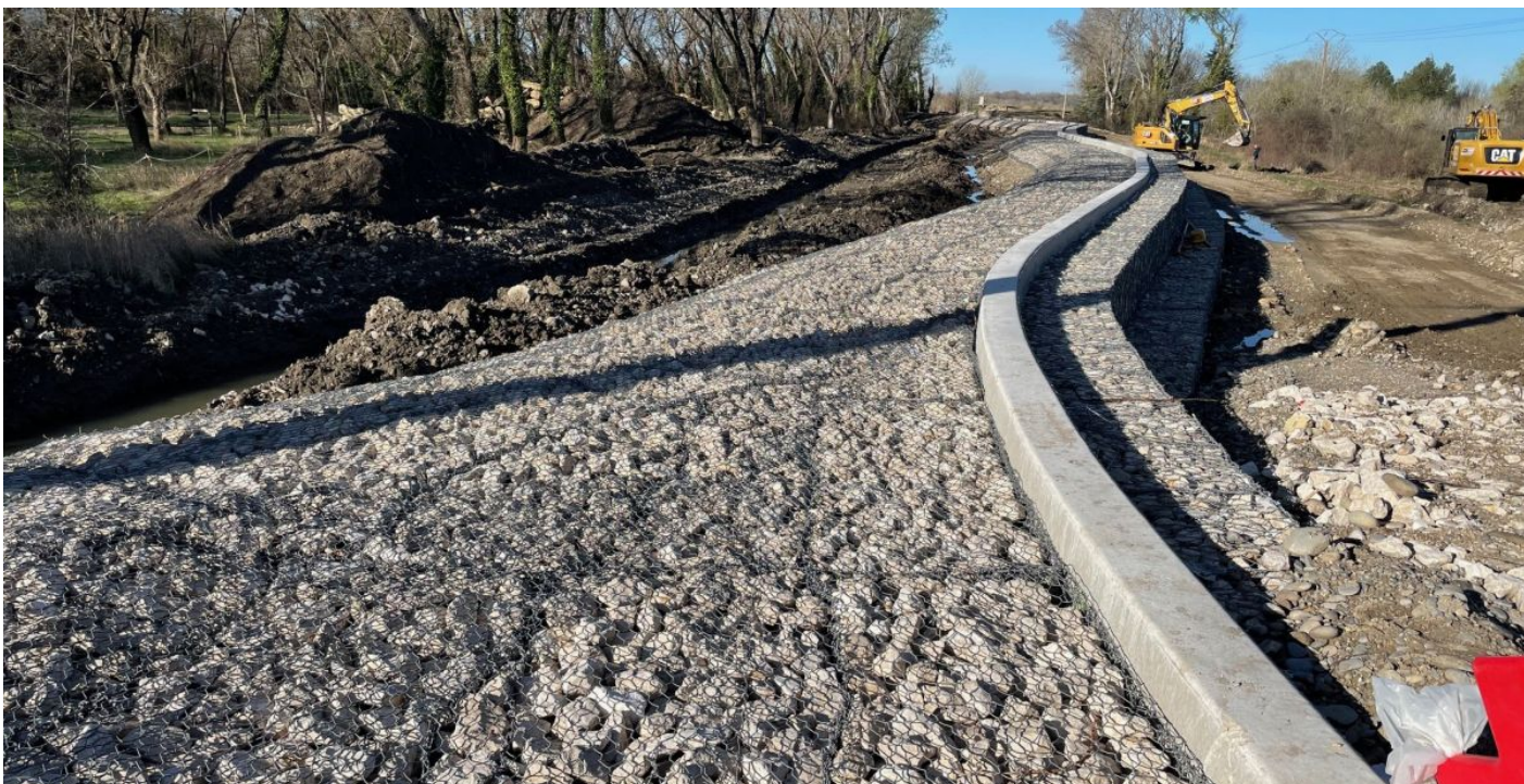
Déversoirs en matelas Reno Plus et gabions
