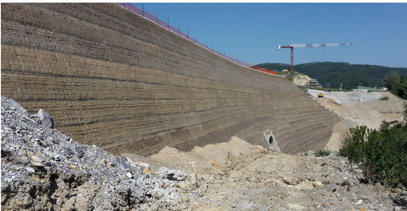
Muro in Terramesh Verde con intersezione di un tombino
