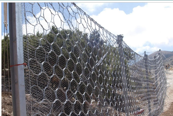
Φράκτης RMC 500A, τοποθετημένος
