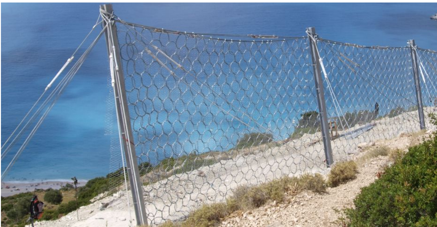
Φράκτης RMC 500A, τοποθετημένος
