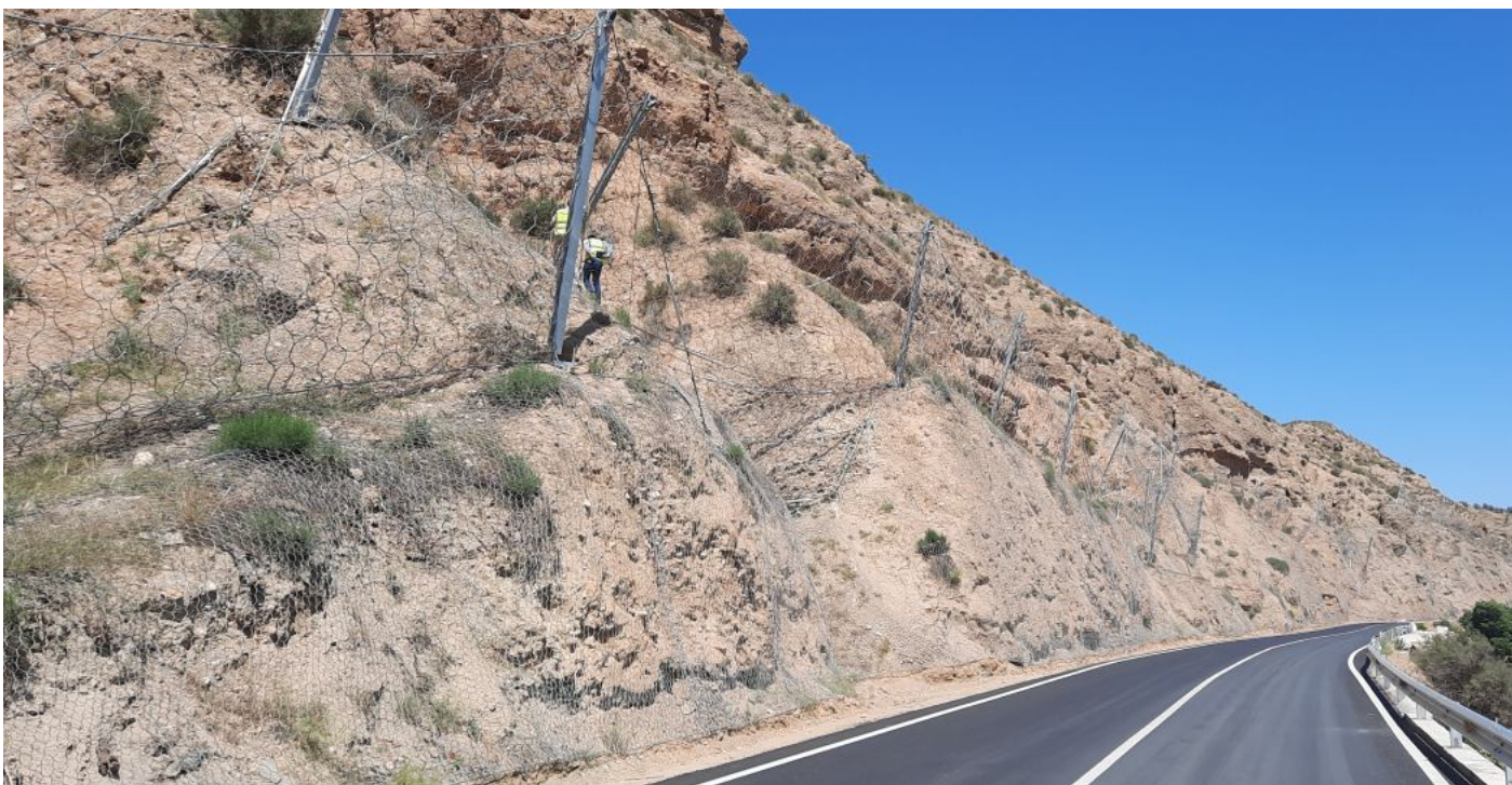
Vista general Barreras, Malla de Doble Trenzado 8x10-16 y faldones
