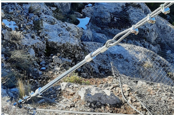
Disipadores y Anclajes barreras dinámicas
