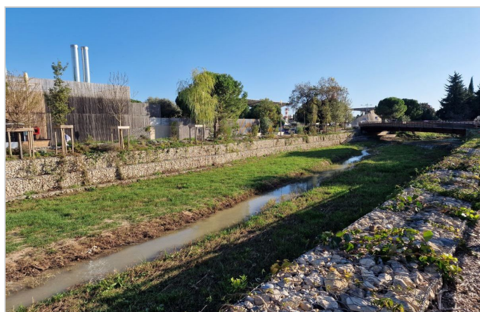
5 mois après la fin des travaux et après une inondation
