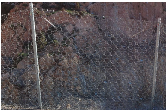
Φράκτης Ανάσχεσης Βραχοπτώσεων
