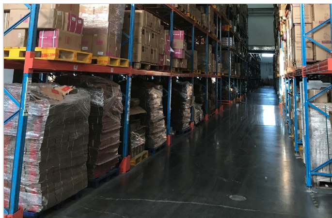
图2-已运行钢筋混凝土地坪库内开裂实拍
