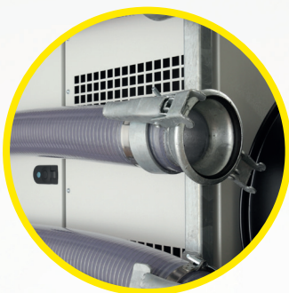
Szívó oldali szerelvények
