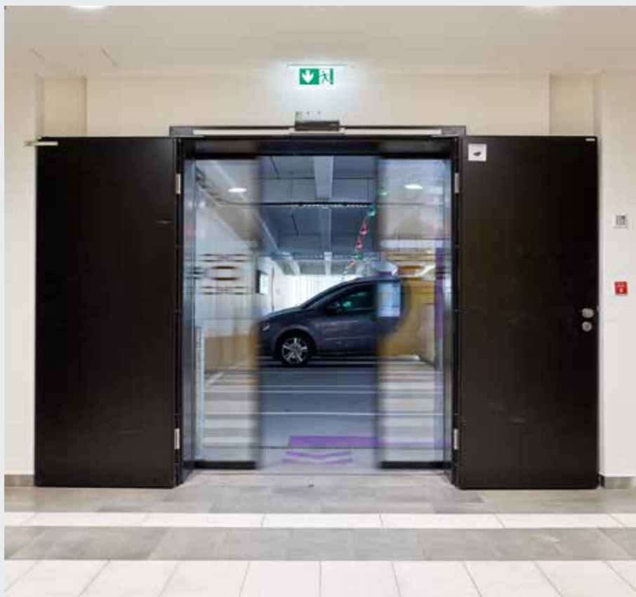
Pogled na protipožarna in dimotesna vrata (delovanje podnevi)
