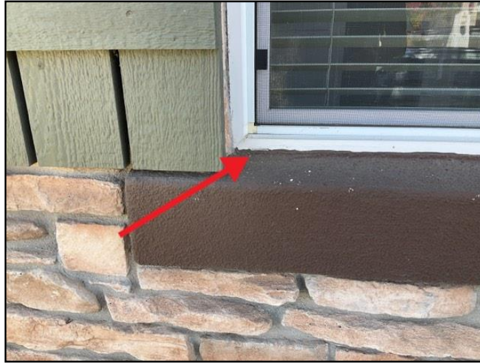
29. Weep Holes Plugged
