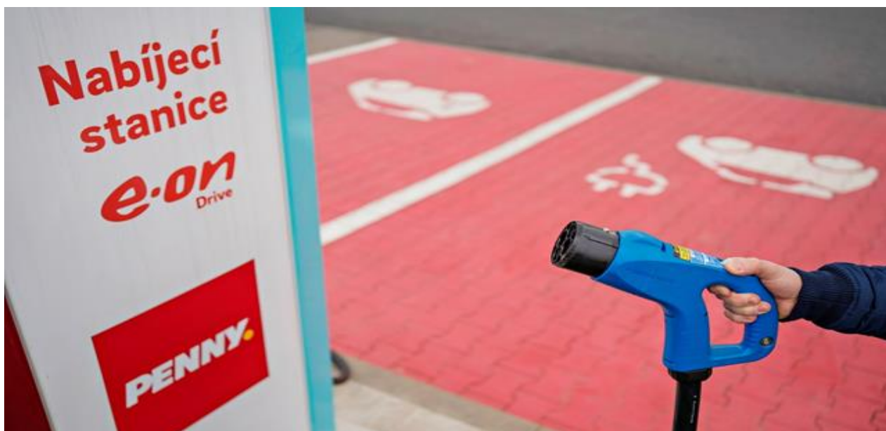
Dobíjecích stanice pro elektromobily.
