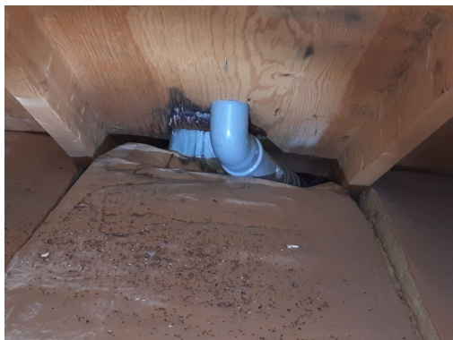
Fuktpreget sutak rundt lufting på yttertak.
