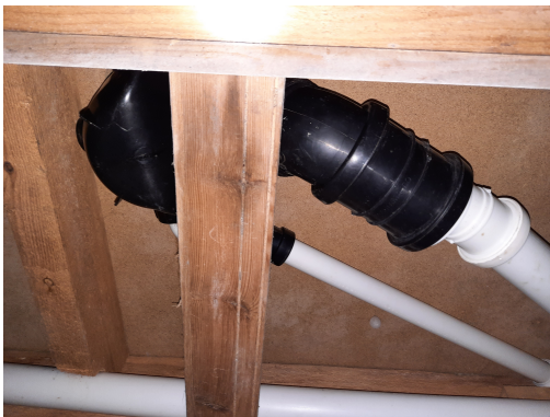
Sluk på bad sett fra underside bjelkelag.
