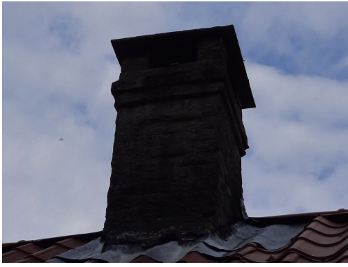
Slitt skorstein over tak.
