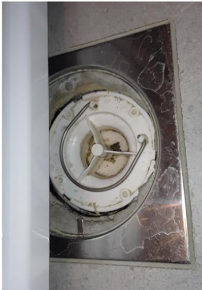
Vaskerom - [Sluk i vaskeromsgulv]
