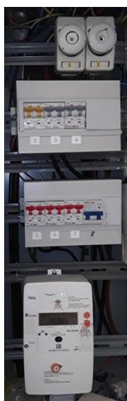
Elektrisk anlegg - [Sikringsskap]
