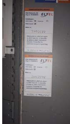
Elektrisk anlegg - [AMS-måler]
