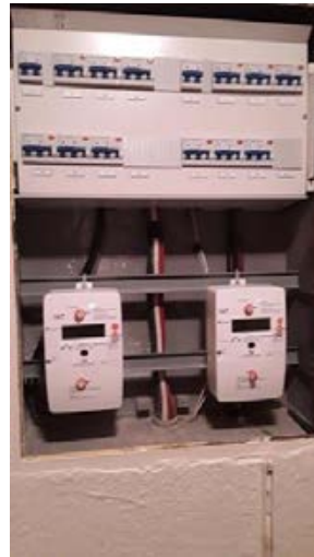
Elektrisk anlegg - [Sikringskap]
