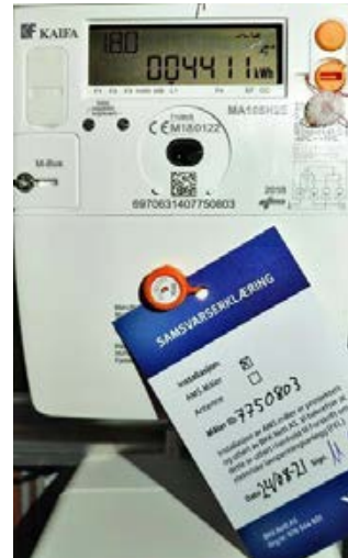
Elektrisk anlegg - [AMS-måler]
