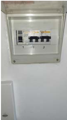
Elektrisk anlegg - [Sikringskap]
