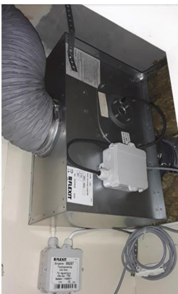
Tekniske anlegg, VVS anlegg (Sjekkpunkter utover det som er inkludert i andre rom) - [Mekanisk avtrekk montert på bad 6. etasje]
