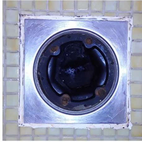
Sluk bad 6. etasje
