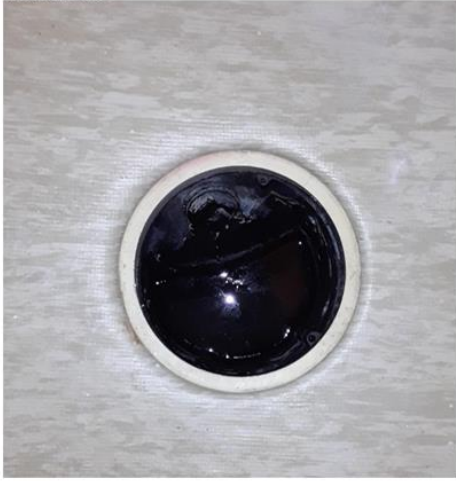
Sluk bad 5. etasje
