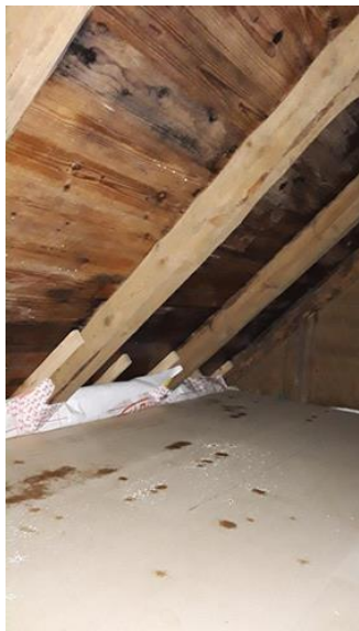
Loft - uinnredet / råloft - [Fuktmerker taktro]
