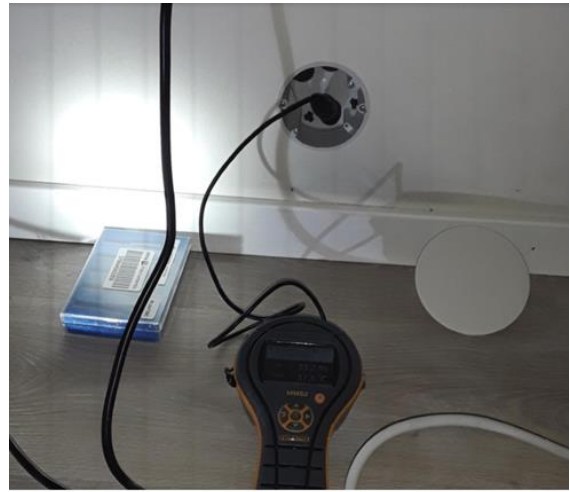
Rom under terreng (kjeller, underetasje, sokkeletasje) - [Hulltaking og fuktmåling i rom under terreng]
