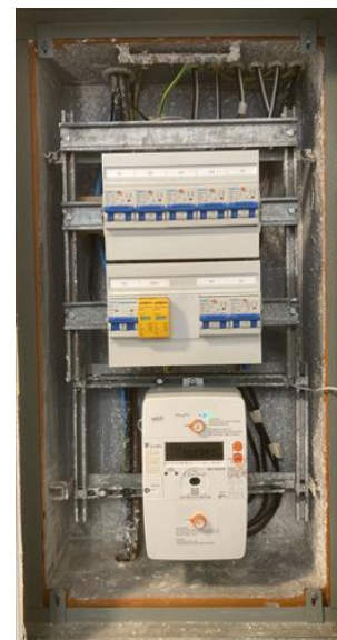
Elektrisk anlegg - [Sikringsskap]
