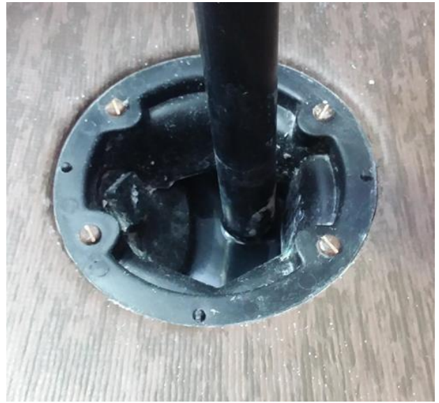
Vaskerom - [Sluk på vaskerom]
