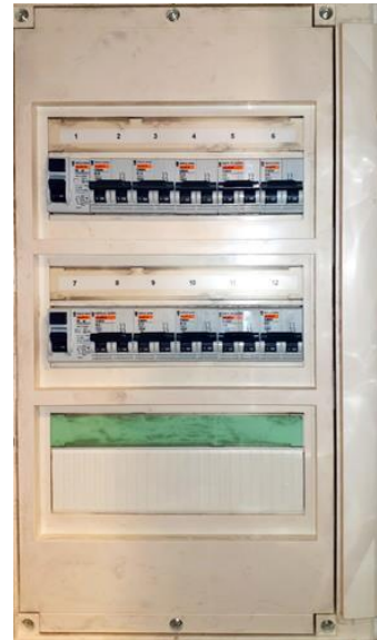
Elektrisk anlegg - [Sikringskapp]
