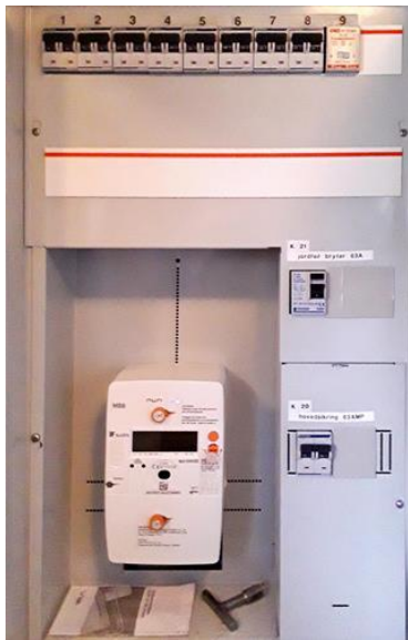
Elektrisk anlegg - [Sikringskap]
