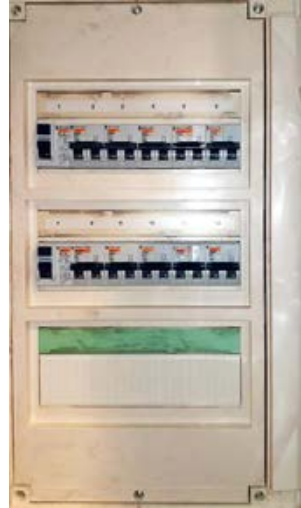
Elektrisk anlegg - [Sikringskap]
