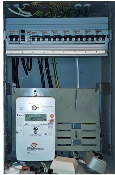
Elektrisk anlegg - [Sikringskap]
