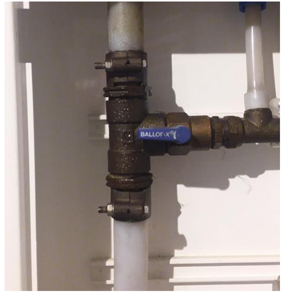
Tekniske anlegg, VVS anlegg (Sjekkpunkter utover det som er inkludert i andre rom) - [Kondens på vannrør i fordelerskap]
