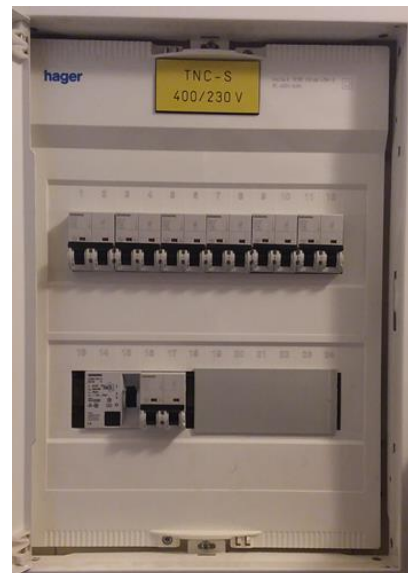
Elektrisk anlegg - [Sikringskap]
