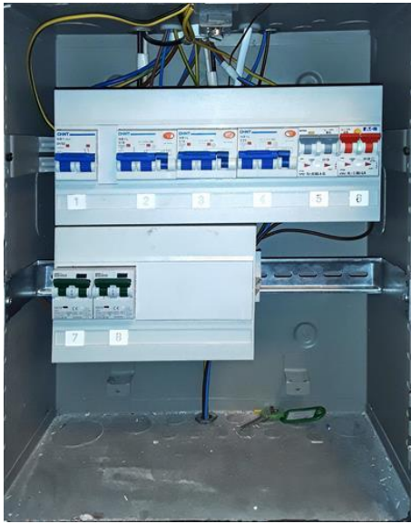
Elektrisk anlegg - [Sikringskap]
