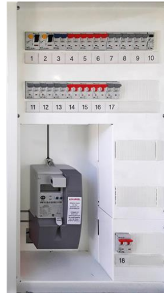
Elektrisk anlegg - [Sikringskap]
