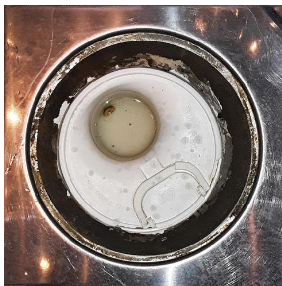
Våtrom - [Sluk bad loft]
