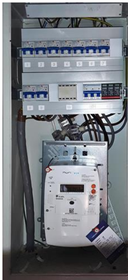
Elektrisk anlegg - [Sikringskap]
