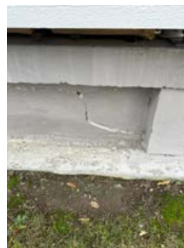
Mindre sprekk under støpt plate.
